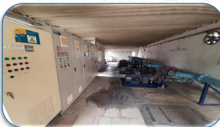
Ilustración 24 Estación de bombeo
