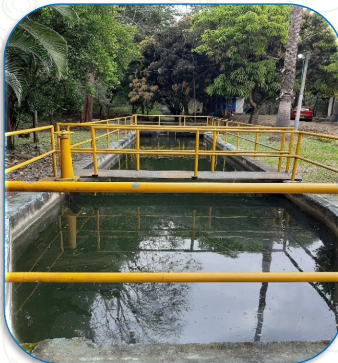
Ilustración 14 Tanque de almacenamiento de agua cruda - bocatoma
