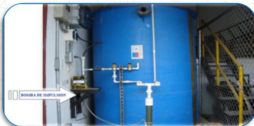
Ilustración 17 Caseta de dosificación PAC
