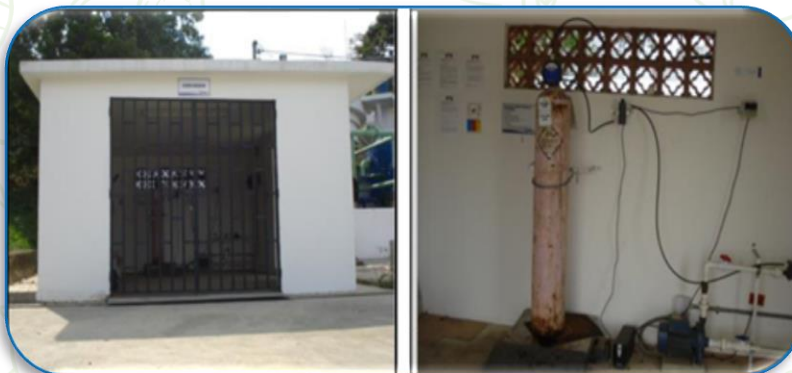
Ilustración 22 Equipo de dosificación de cloro gaseoso
