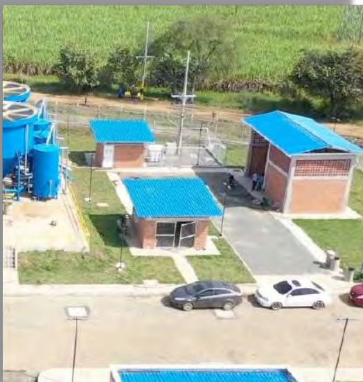
POZO PROFUNDO PLATANARES
